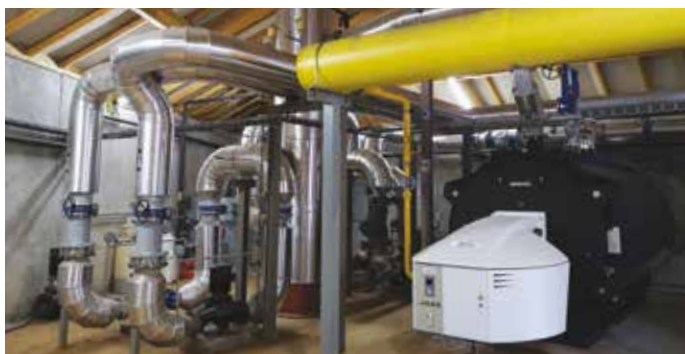
Chaudière à gaz au Centre sportif Richard Bozon
